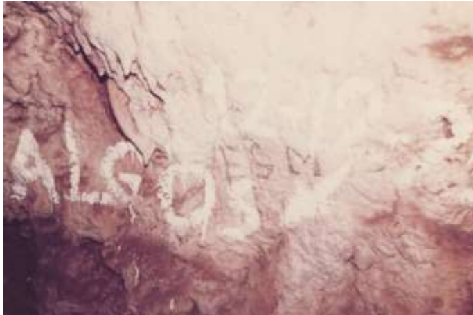
Foto 6- Vestígios de grafismos poluentes visíveis nas paredes.
